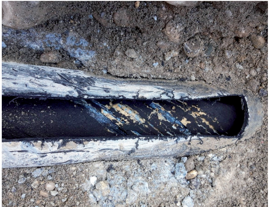
Das defekte Kabel war der Grund für den Stromausfall (Erdschluss).
